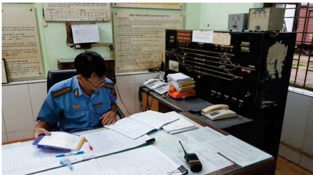
Rysunek 12. Nastawnia dysponująca stacji Ga Sóng Thần na przedmieściach Ho Chi Minh City, do której przylegają dwa obszary ładunkowe, obsługujące największą aglomerację Wietnamu, wyposażona w urządzenia przekaźnikowe i zautomatyzowaną kontrolę zajętości szlaku (wykonane 29.05.2023 r.)
