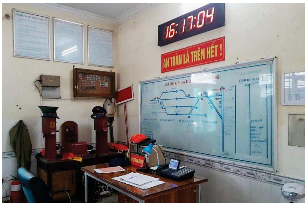
Rysunek 13. Nastawnia dysponująca stacji Ga Phú Diễn na tzw. towarowej obwodnicy Hanoi z widocznymi archaicznymi urządzeniami berłowymi (wykonane 03.06.2023 r.)
