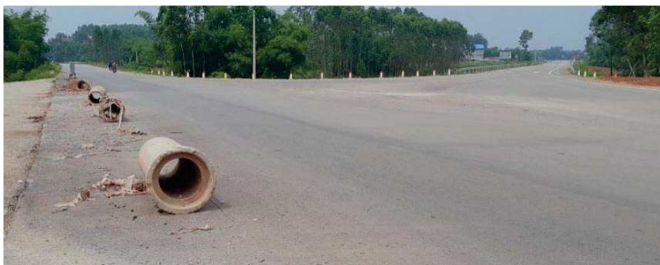
Rysunek 8. Skrzyżowanie dróg o znaczeniu ponadlokalnym w prowincji Lạng Sôn po zakończeniu zasadniczych prac ziemnych związanych z modernizacją (wykonano 13.06.2023 r.)
